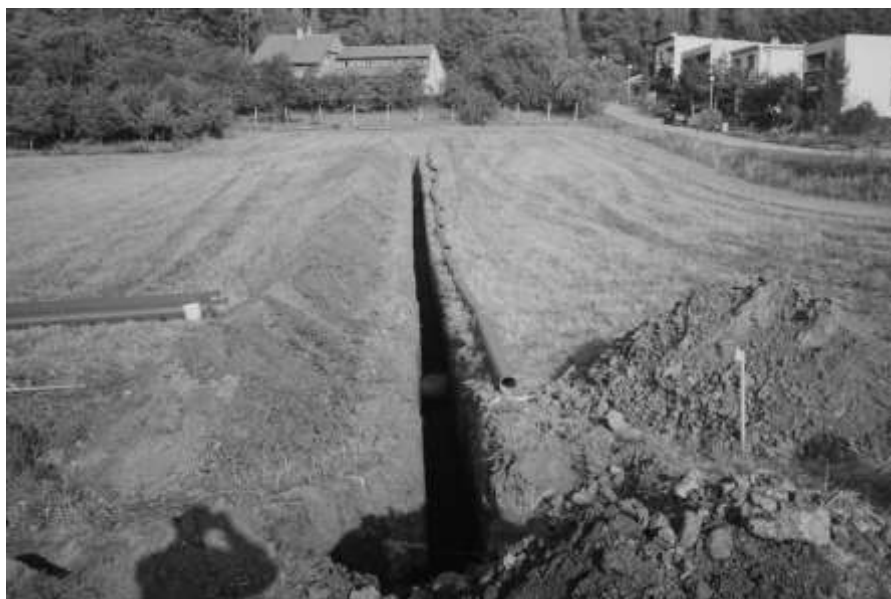
Kanalizace na poli pod hájenkou
